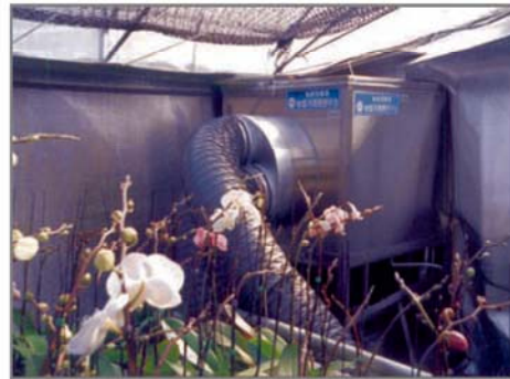
<호접란 온실 냉·난방 히트펌프>
